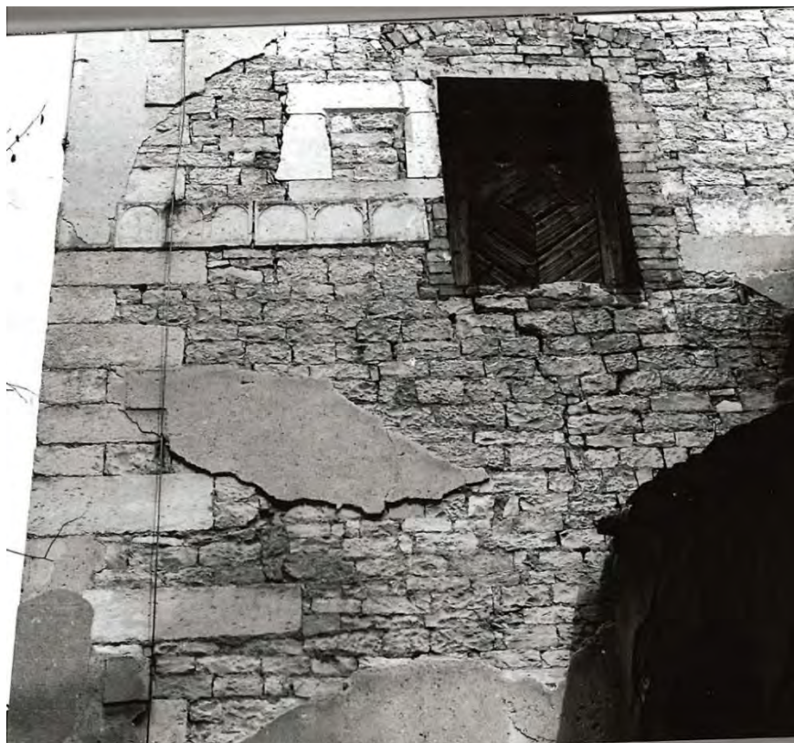
Detail západního průčelí věže s arkádovým vlysem a zalděným obdélným oknem druhého patra věže v pohledu od západu. Foto: Petr Dostál, 1992. Zdroj: Petr DOSTÁL a Martin EBEL, Břvany (okes Louny), stavebně historicků průzkum , Praha 1992.
