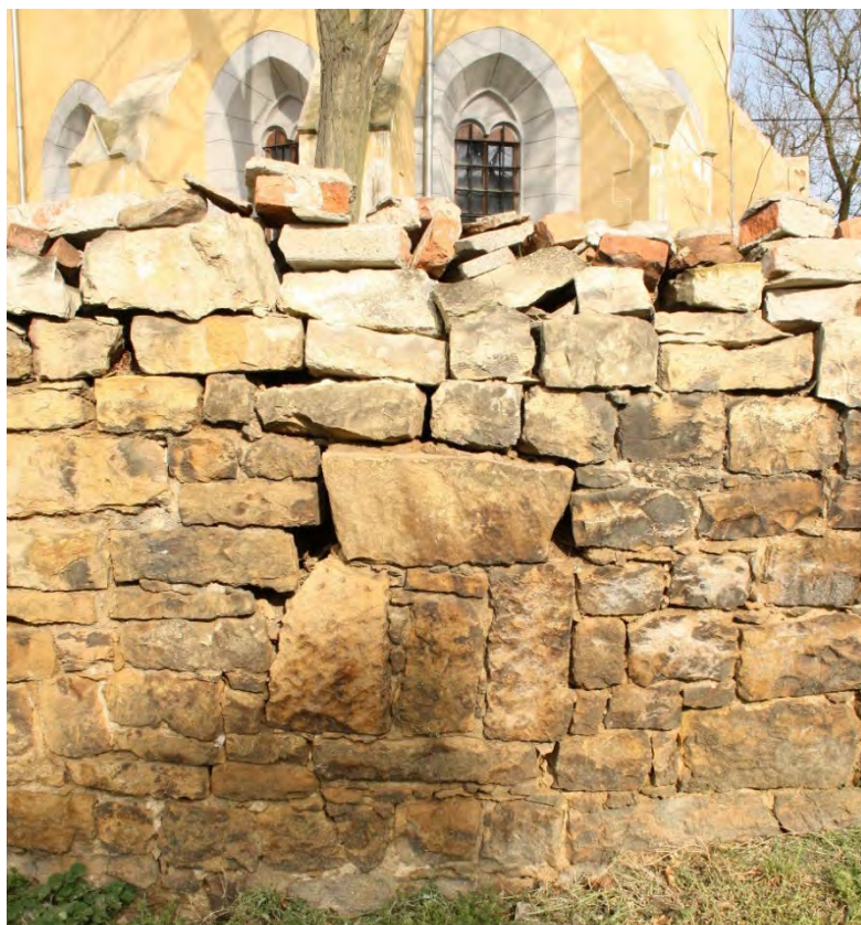
Detail štěrbinového otvoru v jihovýchodním úseku hřbitovní zdi v pohledu od jihovýchodu. Foto: Jaroslav Skopec 2015.
