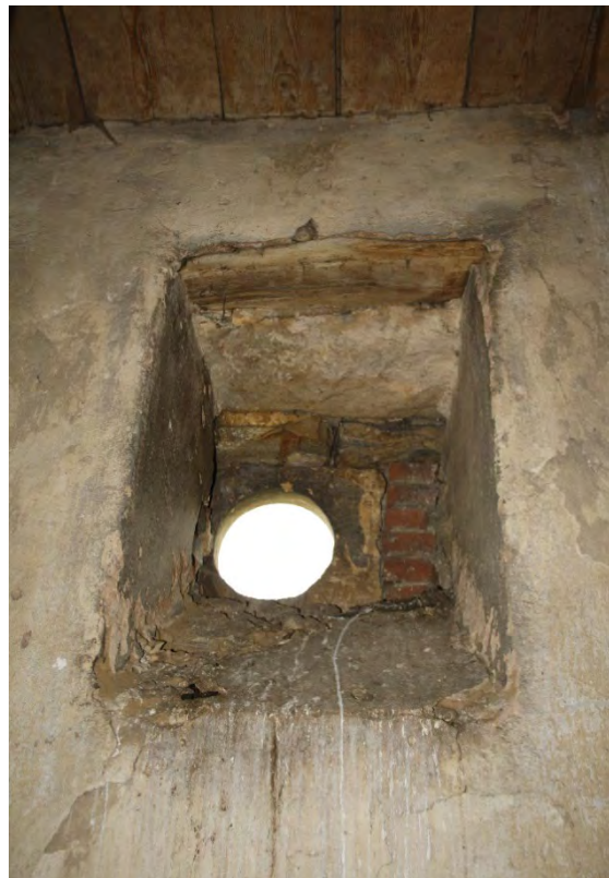
Kruhový okenní otvor jižní stěny oratoře v pohledu od severu. Foto: Jaroslav Skopec 2015.
