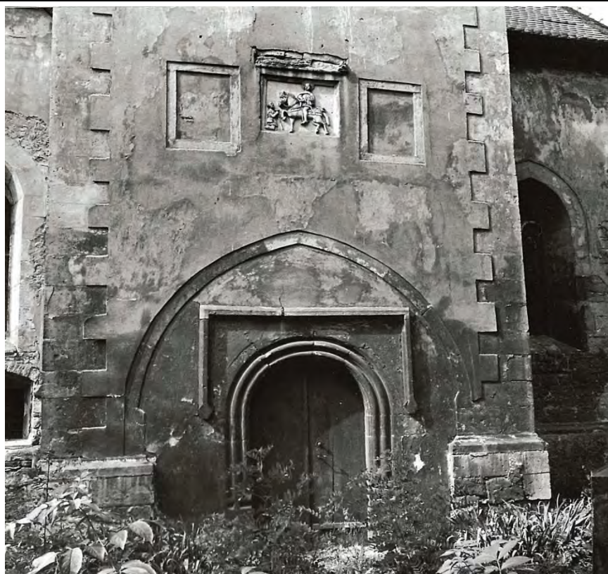
Jižní průčelí patrové předsíně v pohledu od jihu. Foto: Petr Dostál, 1992. Zdroj: Petr DOSTÁL a Martin EBEL, Břvany (okes Louny), stavebně historicků průzkum , Praha 1992.
